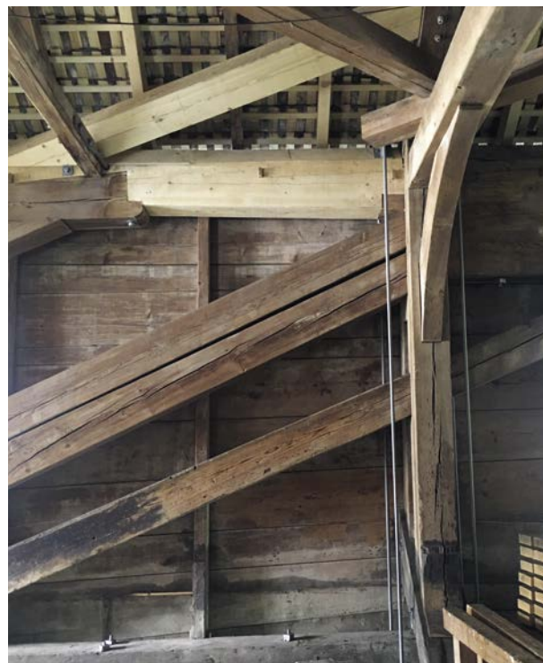
Teilersatz des Obergurts bei der Holzbrücke. Um einen ausreichenden Brandschutz zu gewährleisten, ist eine unauffällige Sprühflutanlage unter der Fahrbahn und eine Brandmeldeanlage in der Dachkonstruktion eingebaut.
